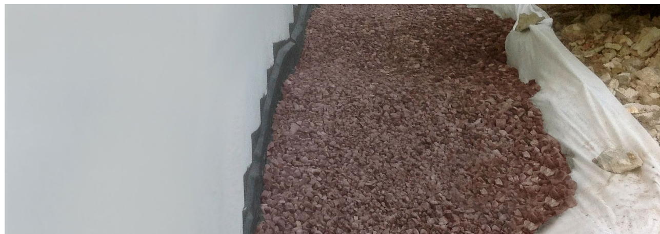
Opvullen van de werksleuf, laag voor laag verdichten van veriso RED geëxpandeerde glaskorrels
